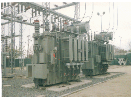
Foto N° 1 PCB en equipos eléctricos
